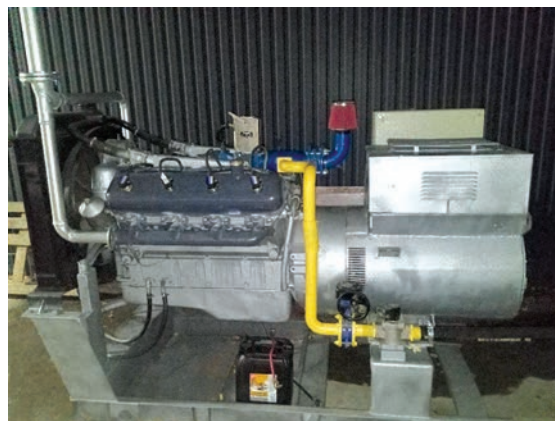
Газопоршнева електростанція у відкритому виконанні. Паливо — генераторний газ
