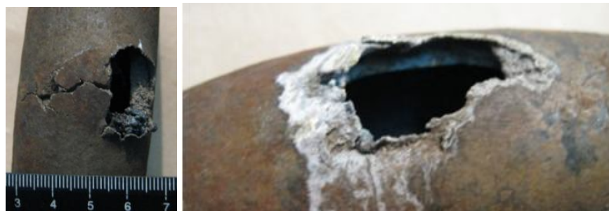
Рис. 1. Крихке руйнування змійовика КПП ВТ II ст. котла ТГМП-204 після тривалого перебування енергоблоку в резерві.
