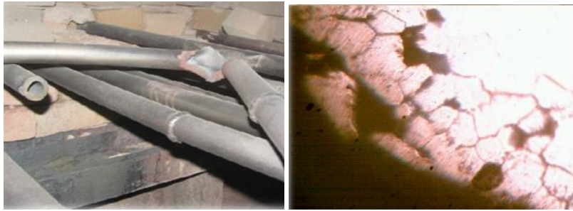
Рис. 3. Зображення крихкого руйнування труб КПП ВТ котла ТПП-210 післянапрацювання 3030 h. Fig. 3. The images of the TPP-210 superheaters boiler tubes brittle destruction after 3030 h.
